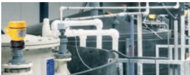
Remplissage de tank
